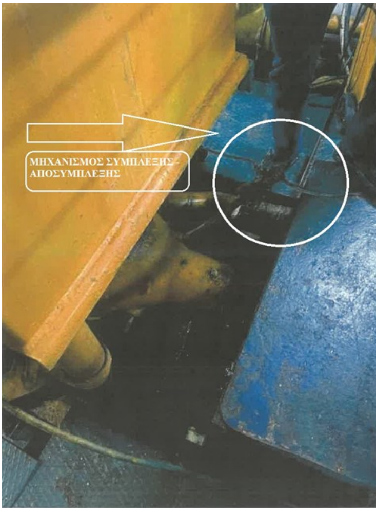
Εικόνα 12: Ο μηχανισμός σύμπλεξης – αποσύμπλεξης του άξονα της κύριας μηχανής με την τροχαλία μετάδοσης κίνησης στο κάτω μέρος του μηχανοστασίου.
