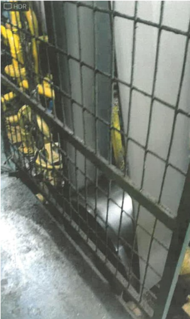
Εικόνα 10: Η τροχαλία μετάδοσης κίνησης, που είναι τοποθετημένη στο κάτω μέρος του μηχανοστασίου και συνδέεται με την Κ.Μ.
