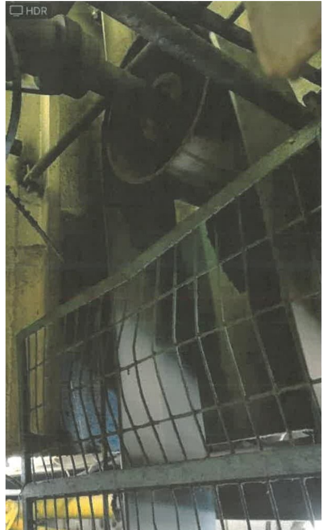
Εικόνα 11: Η τροχαλία μετάδοσης κίνησης, που είναι τοποθετημένη στο άνω μέρος του μηχανοστασίου και συνδέεται με τον μηχανισμό έλξης.
